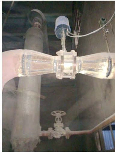
钢铁厂主蒸汽管线流量调节
