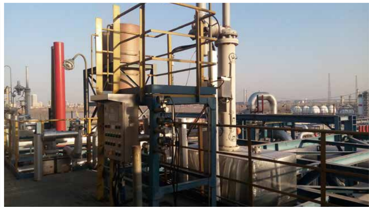
裂解气阀 / 清焦阀在线使用 TLV/DV in operation
